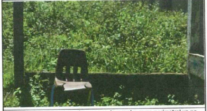
Foto 2: En esta imagen se observa que la pared o muro perimetral ya no está, debido a que se desplomó por la antigüedad de la construcción.
