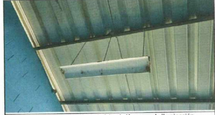
Foto 4: En la imagen se observa la falta de lámparas de iluminación.
