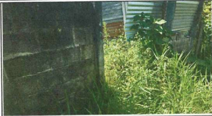
Foto 1: Se observa deterioro del muro perimetral como también cierta inclinación tendiendo a derrumbarse.
