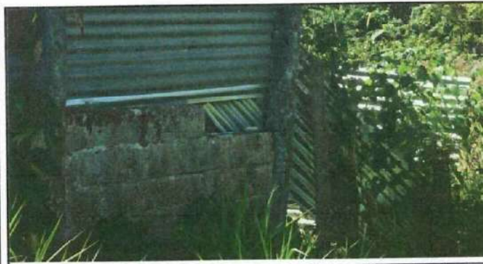
Foto 3: Muro de block totalmente dañado, causando así inseguridad para el establecimiento.
